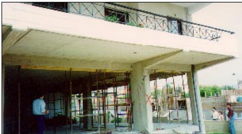
Ρηγγάτωση τοιχώματος πλοτής μετά από σεισμό (Αθήνα, 1999). → Μετασεισμικός έλεγχος. [Αρχείο Ι.Ε.Αβραμίδη]
