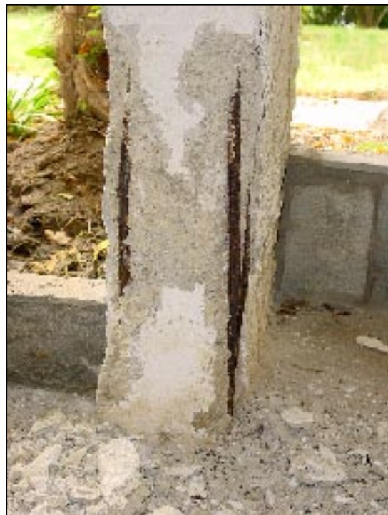
Οξείδωση διαμήκων οπλισμών. Η βλάβη αυτή, σε συνδυασμό με την απουσία συνδετήρων και τη χαμηλή ποιότητα του σκυροδέματος, οδηγεί σε απόφαση προσεισμικής ενίσχυσης.
