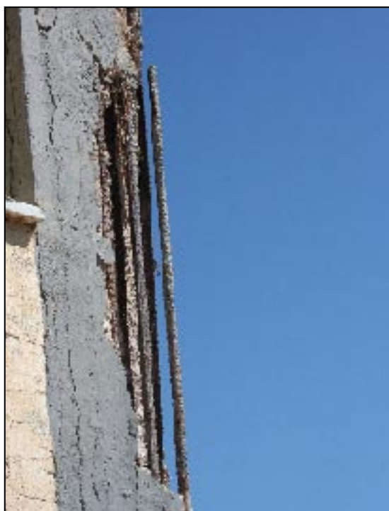
Απόσπαση επικάλυψης και οξείδωση οπλισμού υποστυλώματος. Είναι φανερή η απουσία συνδετήρων! → Προσεισμικός έλεγχος. [Αρχείο Θ. Σπηλιόπουλου].
